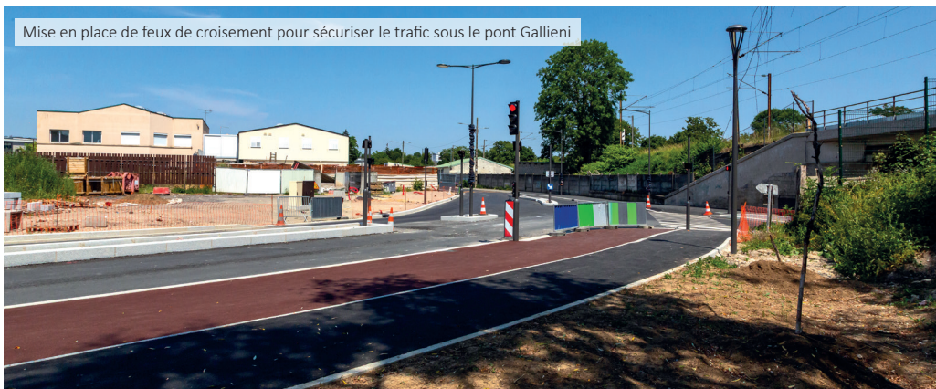
Travaux en cours sur les portions des rues Gallieni et Jean Bouin
